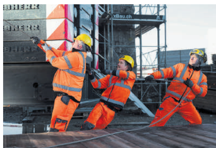
HAU RUCK! Auf den Baustellen wird jetzt mit Hochdruck gearbeitet, um Corona-Verzögerungen aufzuholen. FOTO: KEYSTONE
